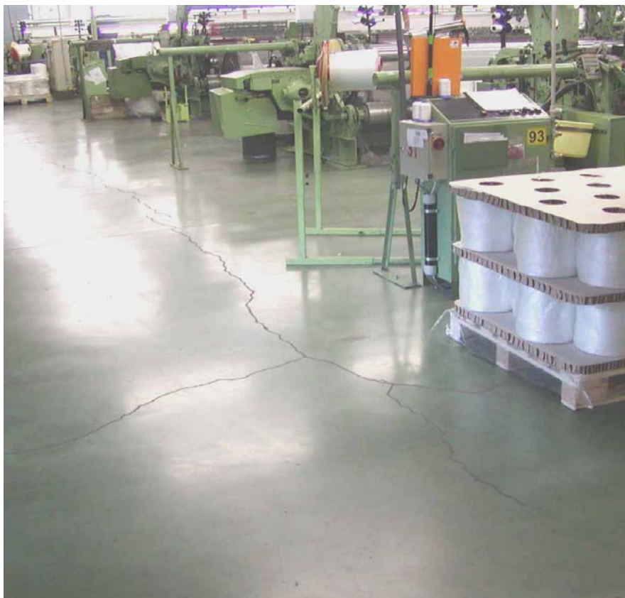
Obr.2 Trhliny v podlaze v mezisloupových pruzích 15–16
